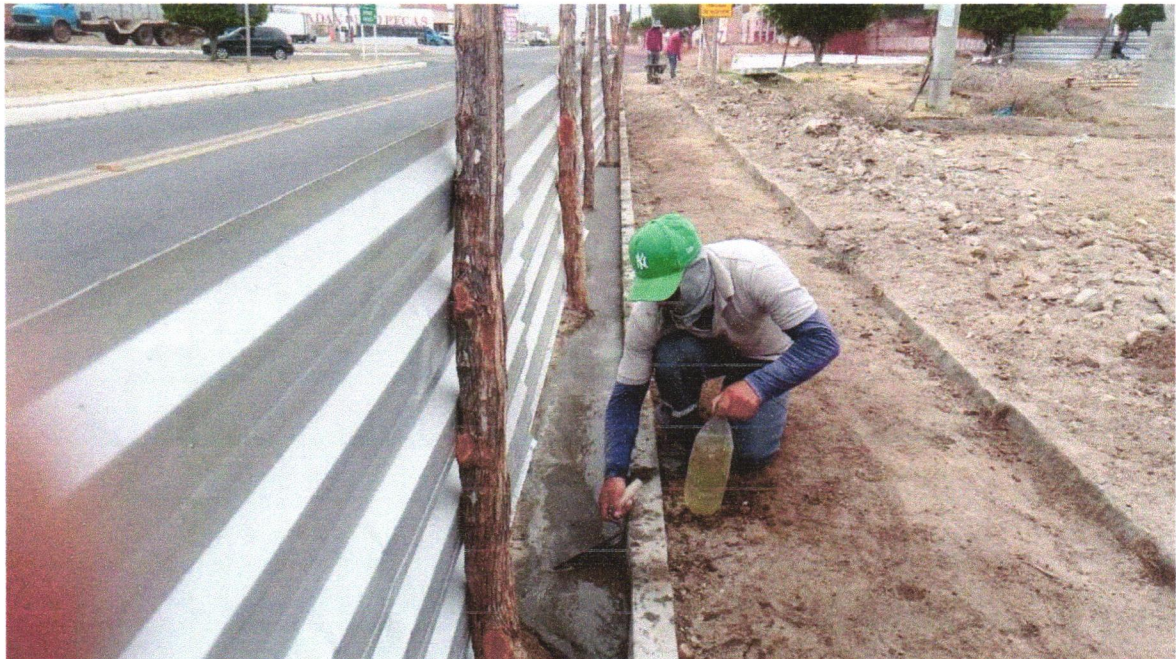
Foto 03- ASSENTAMENTO DE GUIA (MEIO-FIO) EM TRECHO RETO, CONFECCIONADA EM CONCRETO PRÉ-FABRICADO, DIMENSÕES 100X15X13X20 CM (COMPRIMENTO X BASE INFERIOR X BASE SUPERIOR X ALTURA), PARA URBANIZAÇÃO INTERNA DE EMPREENDIMENTOS. AF_06/2016_P
