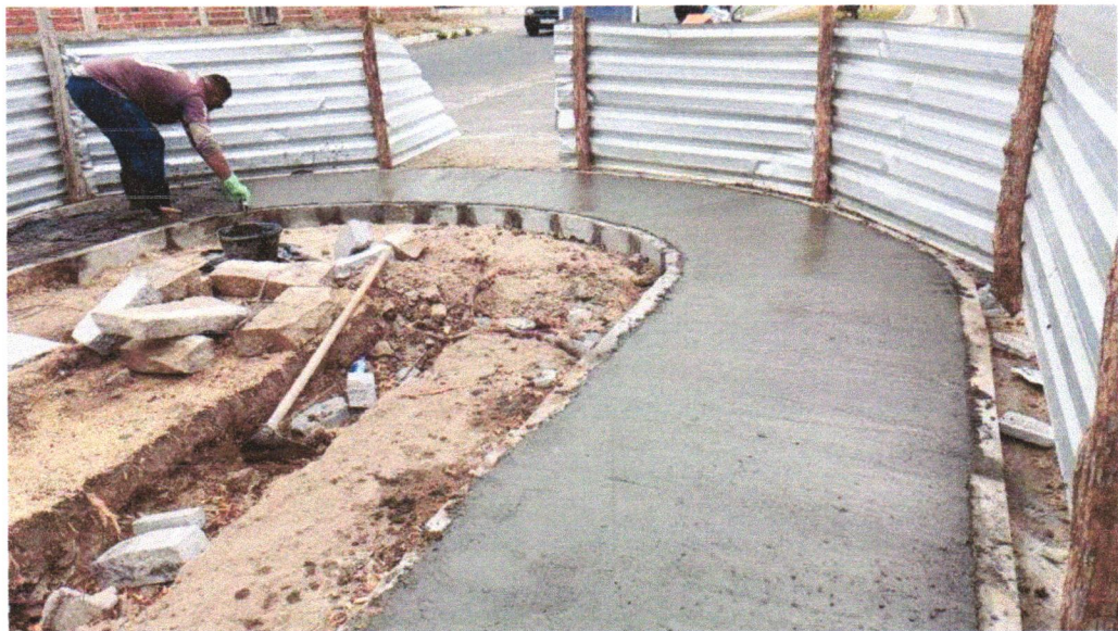
Foto 07 - PAVIMENTAÇÃO EM CONCRETO, COM ESPESSURA DE 7 CM, COM ACABAMENTO FEITO UTILIZANDO ALISADORA DE CONCRETO (HELICOPTERO), INCLUIDO TELA DE AÇO SOLDADA NERVURADA CA60, Q196 (3,11 KG/M 2 ), DIAMETRO DO FIO 5.0 MM, LARGURA = 2,45 M, ESPAÇAMENTO DA MALHA = 10 X 10 CM, JUNTA DE DILATAÇÃO EM PVC A CADA 2,00 M, CONCRETO FCK = 20 MPA
